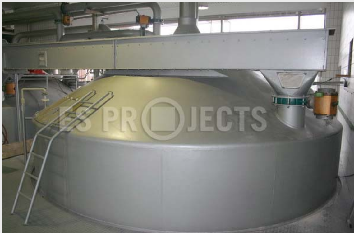
Chaudière de Trempe
