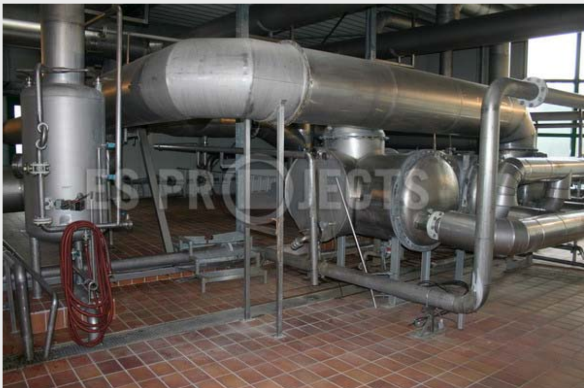
Condensateur de Vapeur
