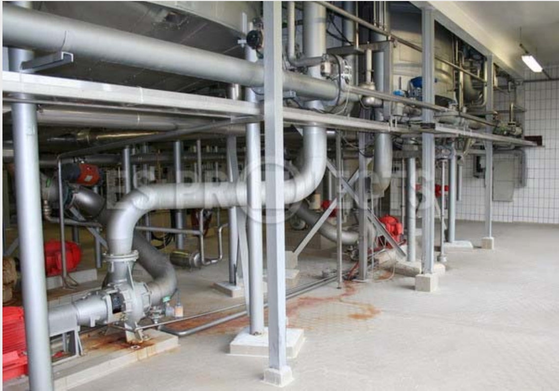
Chaudière de Trempe
