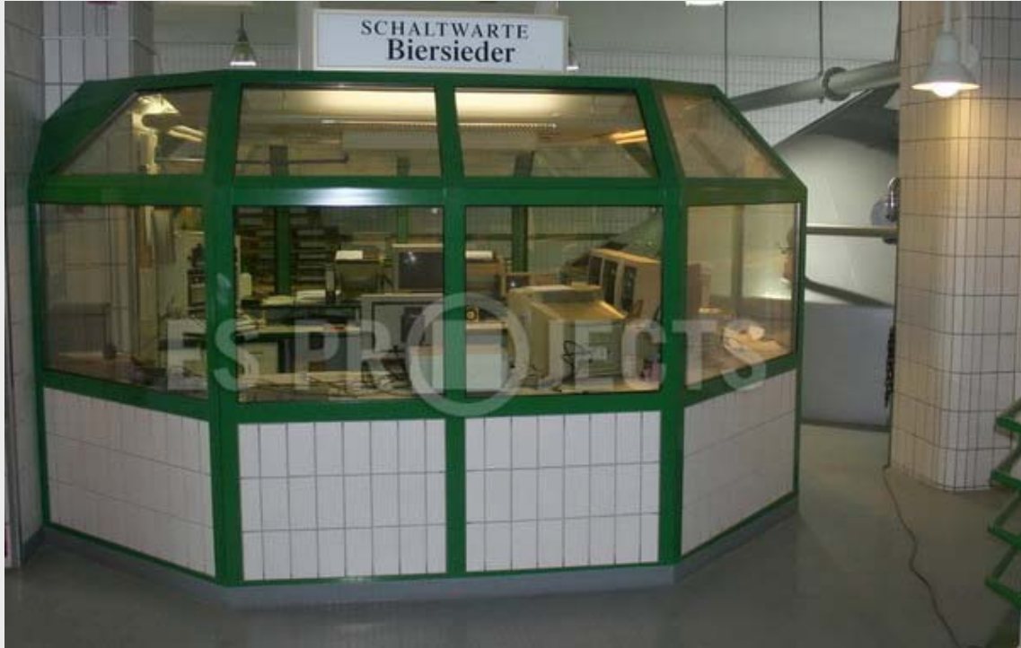
Salle de Commande
